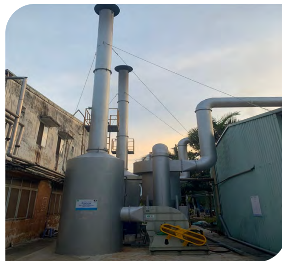
越南工廠鍋爐空氣汙染防制設備
